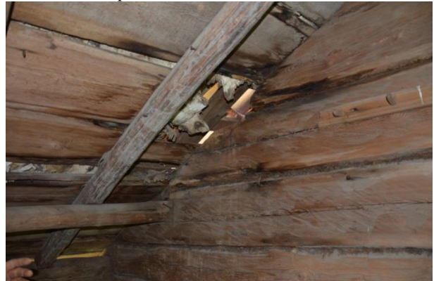
Rötskador i timmerstomme. Vlm_kmvFE-1333
