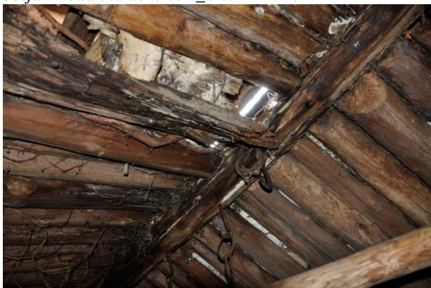
Rötskador på undertak. Vlm_kmvIM-2720
