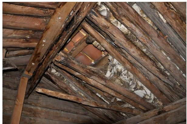
Mer rötskador på undertak. Vlm_kmvIM-2723
