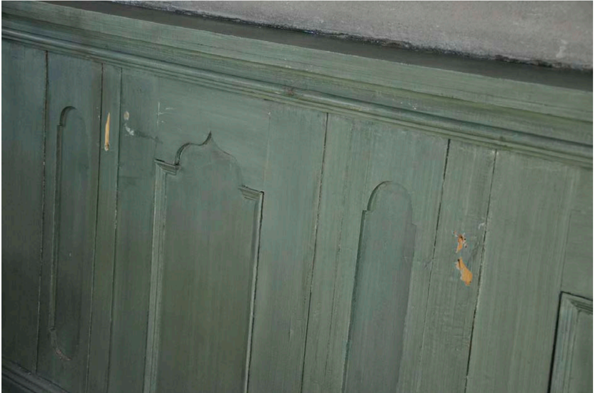
Skador på panelen efter bänkarnas infästning.
