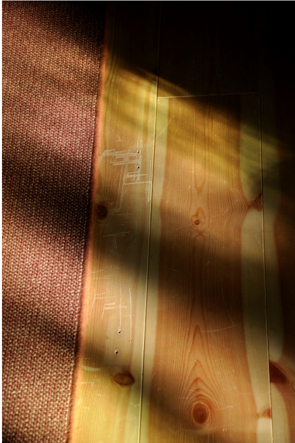
Grova repor i trägolvet bör åtgärdas.
