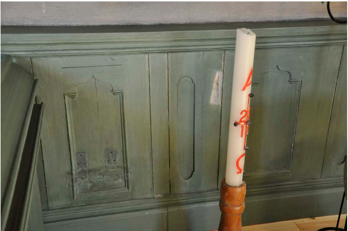
Skador på panelen efter infästningar av bänkarna bör retuscheras.
