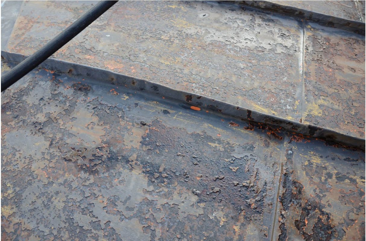
Detalj av tak efter blästring. Flera färglager är synliga och den orangefärgen är rester av blymönja.
