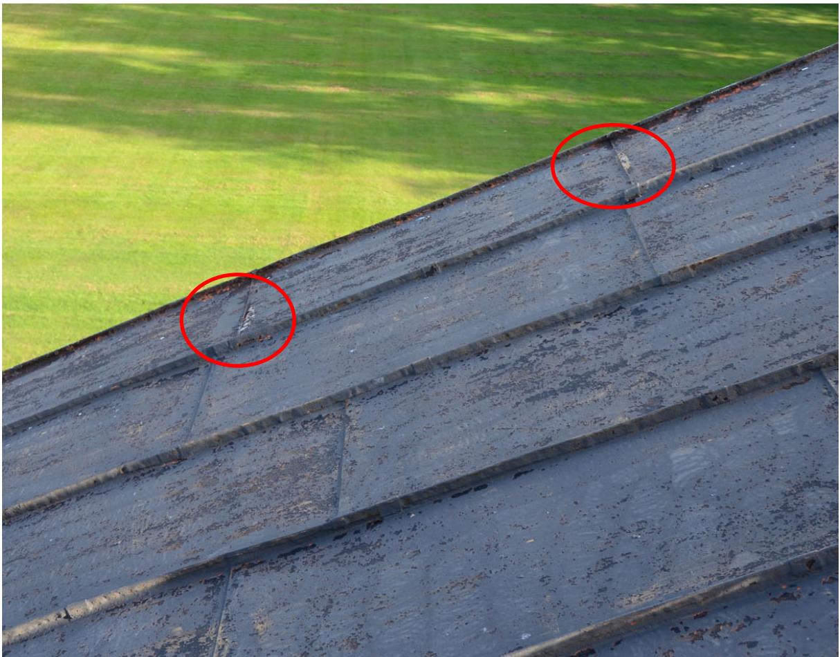
Några rostangrepp och mindre hål blev synliga efter blästringen.
