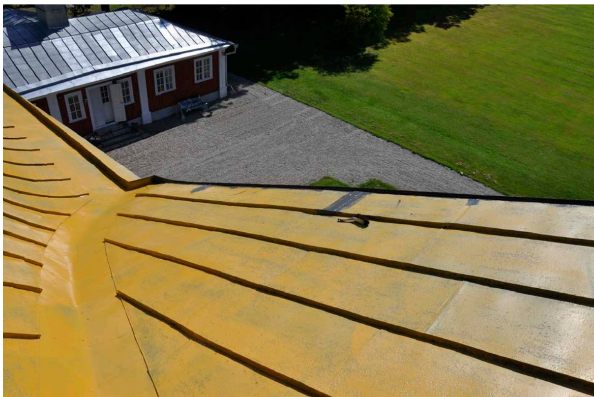
Rostangreppen lagades med kitt, här gråmålade efter grundmålningen.
