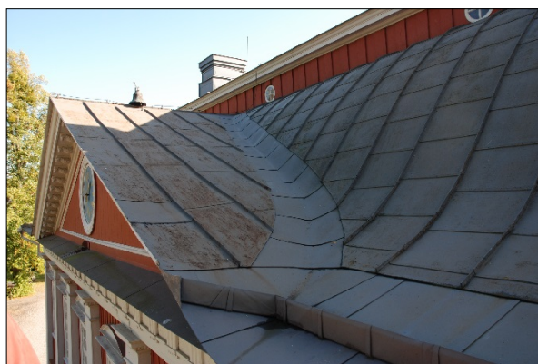
Tak mot norr med färgsläpp och rost. Foto från VLM:s besiktning 2009.
