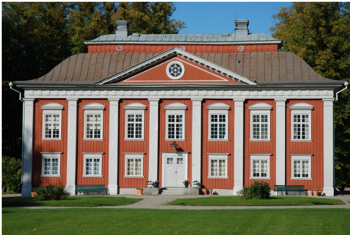
Huvudbyggnadens södra fasad. Taket har färgsläpp och rostangrepp. Färgskillnaden mellan italianen och de övriga taken är markant. Foto från VLM:s besiktning 2009.
