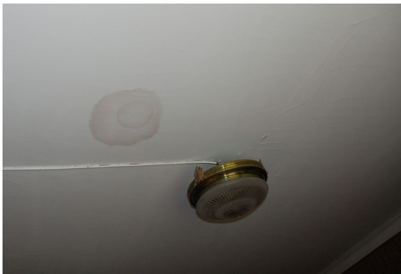
Fuktros i papptak i rum på övre våningen. Vlm_kmøLS-626
