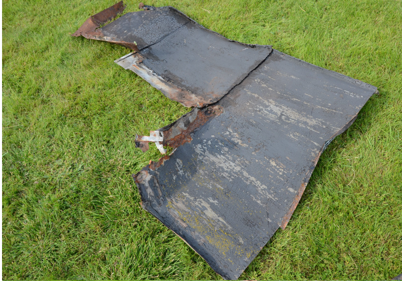
Nedtagen plåt. Vlm_kmvLS-1968
