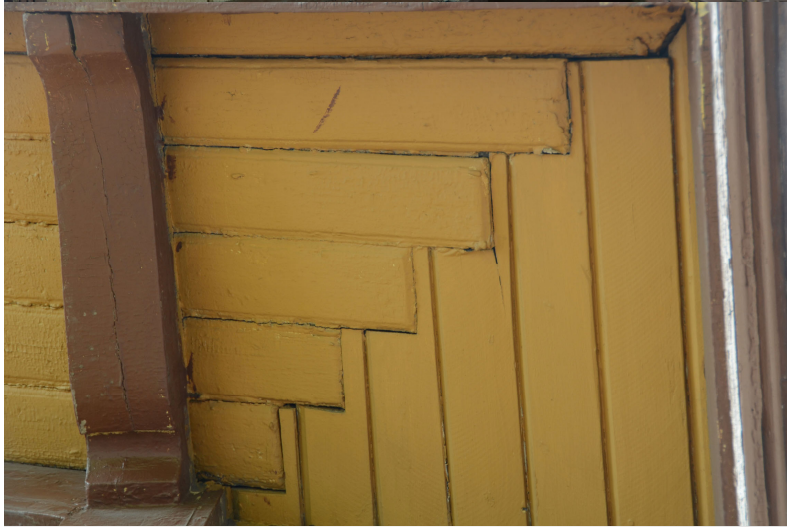
Tidigare utbytta undertaksbrädor i takfoten på södra takfallet. Lagningar utförda då byggnaden fortfarande var i SJ's ägo. Vlm_kmvLS-1971
