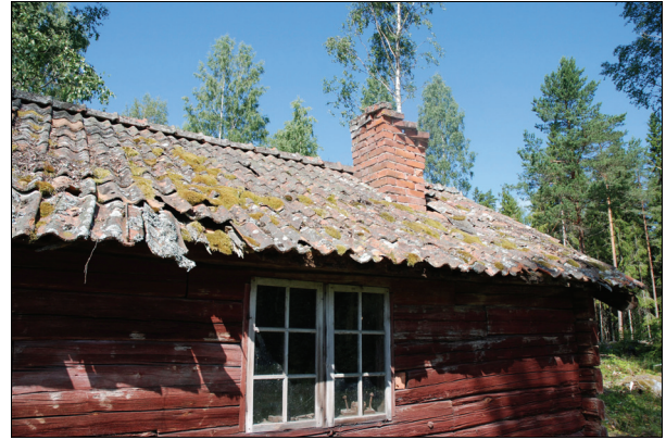
Många pannor hade glidit ur läge eller fallit ned. Bildnr Vlm_abgFE-211.
