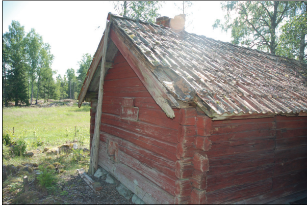
Vindskivorna på den norra sidan var kraftigt rötskadade. Bildnr Vlm_abgFE-208.
