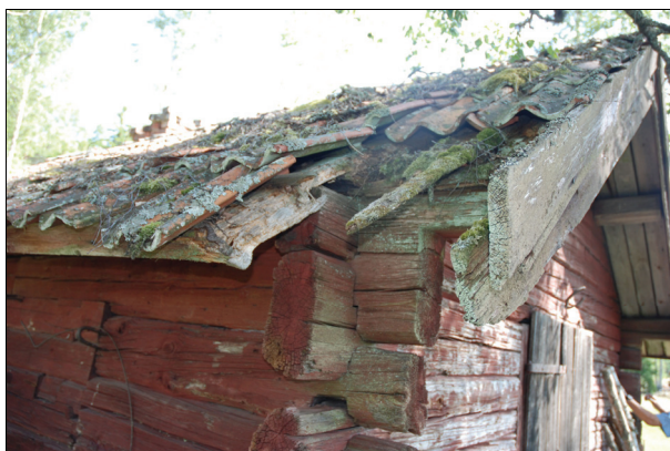
Det fanns flera synliga rötskador på taket. Bildnr Vlm_abgFE-204.
