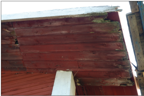
På takutsprånget fanns rötskador på grund av läckage genom taket. Bildnr Vlm_kmvIM-1321.
