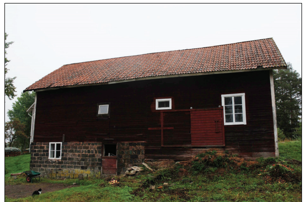
Byggnadens västra fasad före restaurering. Denna sida var i något sämre skick med nedfallna tegelpannor. Bildnr Vlm_kmvLS-488.
