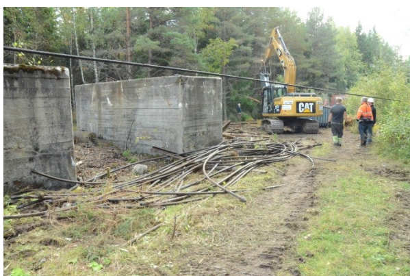
Rester av linor låg utspridda i gräset. Vlm_kmvFE-3778
