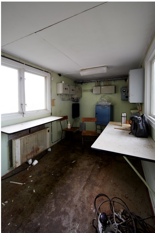
Hytt för operatör vid stationen på Knotberget. Foto: Lasse Fredriksson
