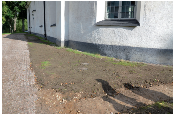
Kyrkans från SV efter åtgärder. Gräset har släntats av för att förhindra vattenansamling. Vlm_kmvFE-1683
