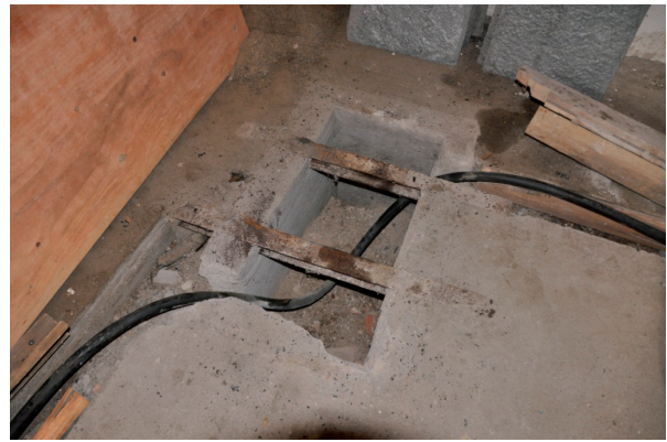
Befintlig pumpgrop i sakristians källare. Den nya pumpen utgick, men gropen behövs för eventuella framtida installationer. Gropen täcktes över med durkplåt. Vlm_kmvFE-1552.
