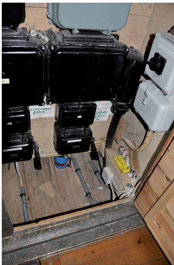
Elcentral under predikstolen i kyrkan, ledningar löper under golvet. Vlm_kmvFE-1553.
