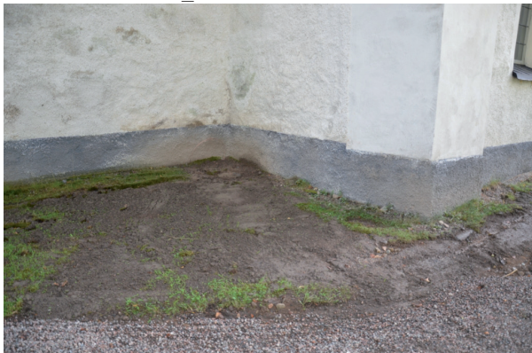
Bild från NV vid hörnet till tornet och vapenhuset. Efter slutfört arbete. Vlm_kmvFE-1679
