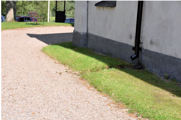
Kyrkans SV fasad innan åtgärderna. Gräset bildade en vall som vatten samlades i vid regn. Vlm_kmvFE-1546.
