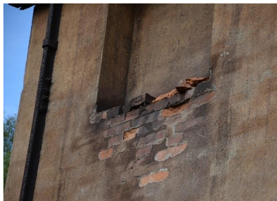
Putsskador på byggnaden sydvästra fasa i höjd med hyttans andra våning.
