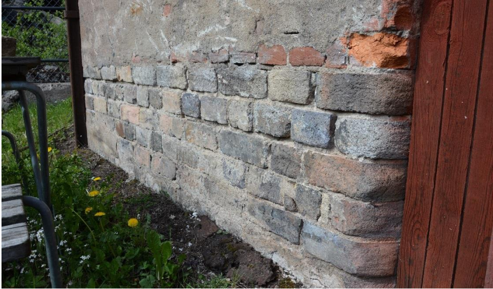
Byggnadens nedre murskift med putsbortfall och viss frostsprängning. Fotot visar de avrundade hörnstenar som återfinns på de nedre partierna intill portöppningarna.
