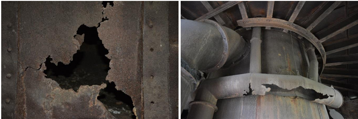
Detaljer från malmfickorna och gasledningarna där rosten har ätit sig igenom det tunna materialet.
