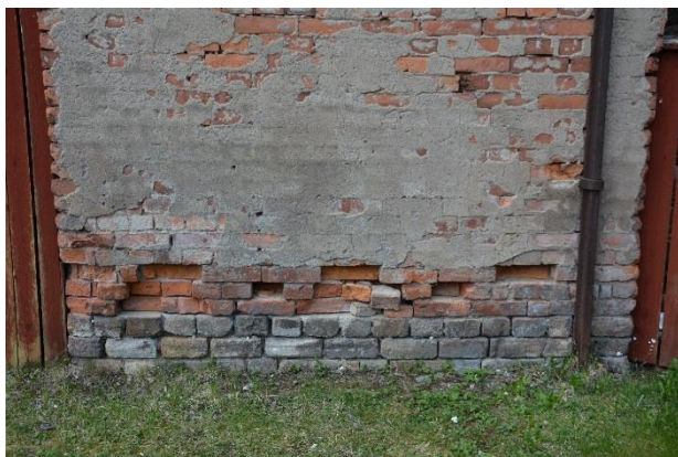
Exempel på skador på byggnaden sydöstra fasad, nedre murskift med putsskador.
