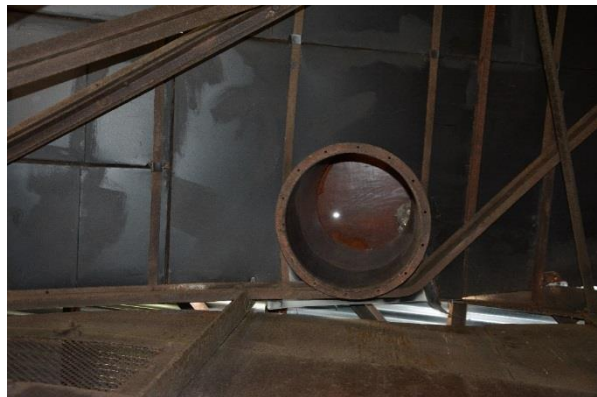
Ventilationsskorstenen verkar dels vara stängd samt innehålla getingbo.
