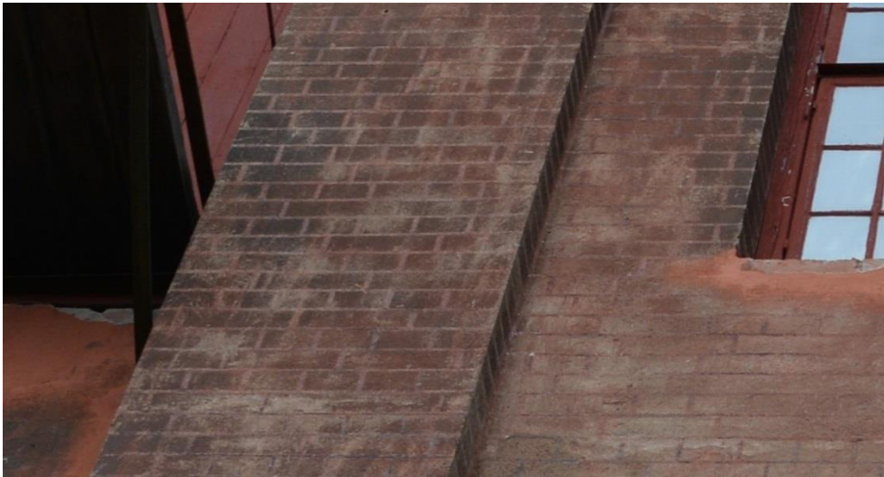
Hyttans övre del där putsen har infärgats röd och dekorerats med tegelimiterande dekor. Under fönster och spelhjulsplattformen syns tidigare putslagningar.
