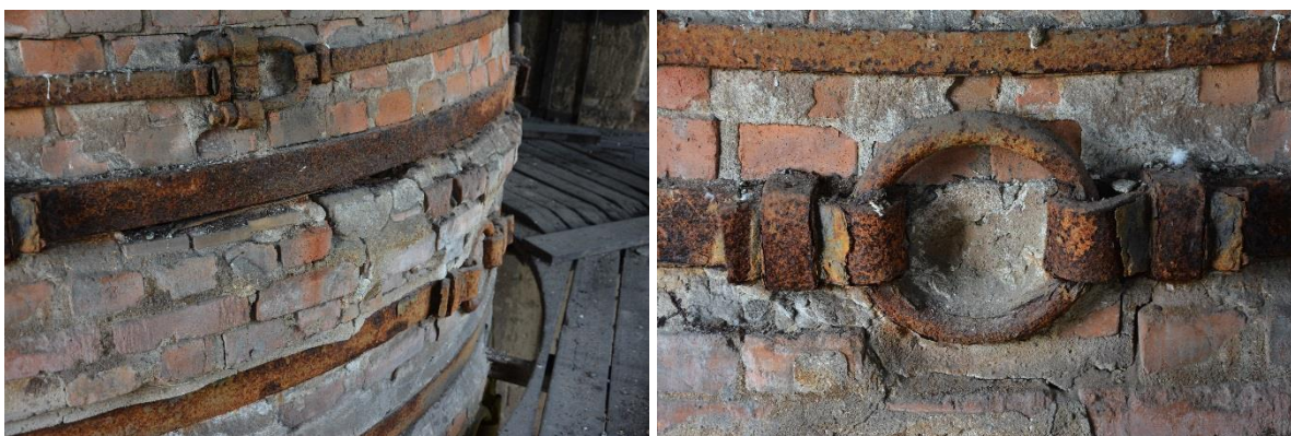
Järnband och tegelmur på plan 3 är i behov av åtgärder.
