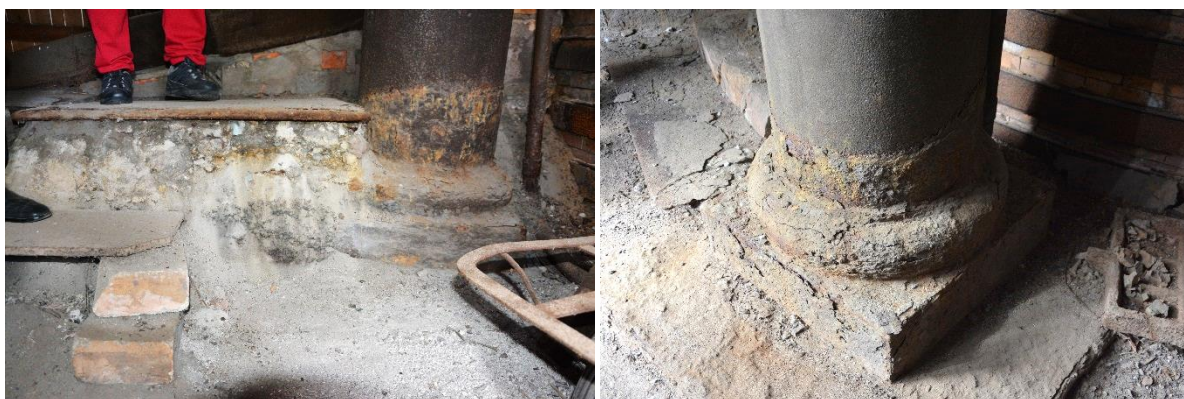
Golvnivån sänktes vid renoveringen 1994 för att stoppa korrosionen på gjutjärnspelarna på bottenplan. Pelarna har inte skadats ytterligare.
