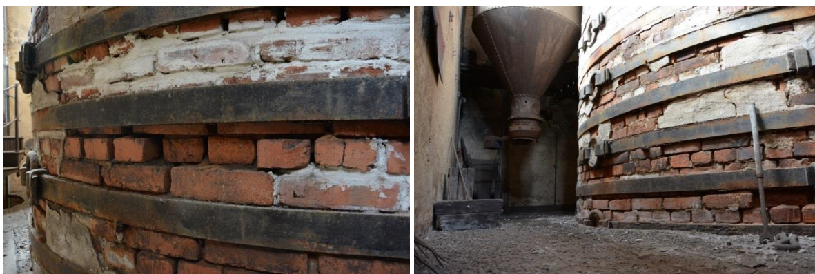
Pipans stenar och putslager på plan två är i sämre skick än på grundplan. Järnband är fortfarande i ok skick.
