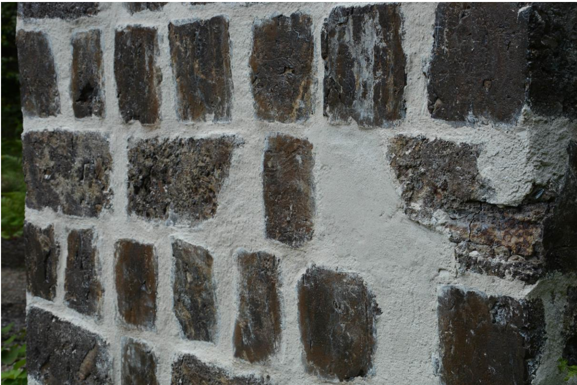
Detaljbild på färdigmurad pelare med slät fog under 2017. Pelare utfylld med bruk vid trasiga stenar. Vlm-kmvek-1610.
