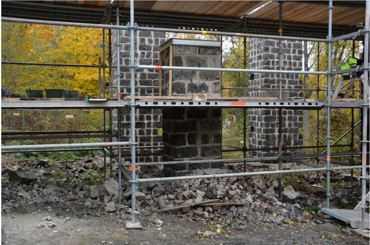
Pelare som på grund av frostsprängning har rivits ned och murats upp igen. Pelaren är alltså betydligt lägre än var den ursprungligen var. Foto taget i oktober 2018. Vlm-kmvek-2038.
