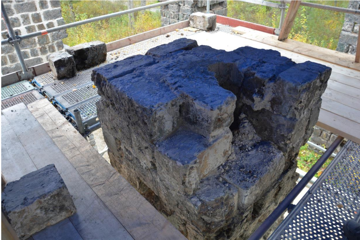
Toppen av en pelare under restaureringsarbetet, notera hålet i mitten av pelaren. Skadade stenar plockas bort och ersätts. Foto taget i oktober 2018. Vlm-kmvek-2054.
