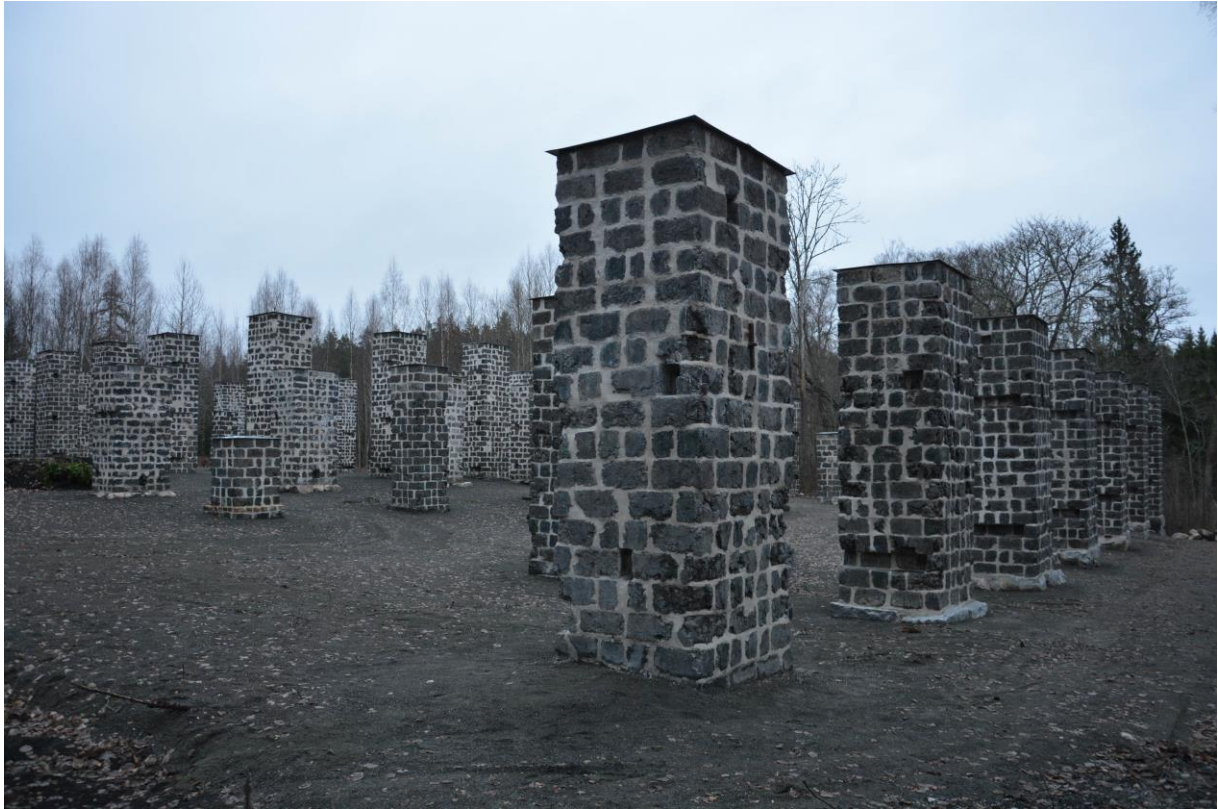
Pelare 50 närmast i bild i kolhusets södra rad, det vill säga etapp VII, och resterande pelare inom etappen till höger i bild. Bilden är tagen vid slutbesiktningen i november. Hela området är täckt av stennjöl. Vlm-kmvek-2934.
