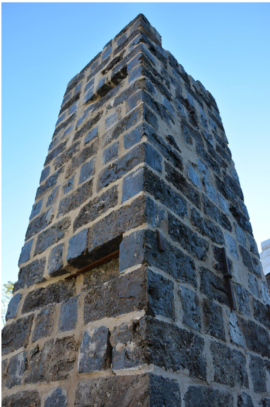
Färdigrestaurerad pelare inom etapp 1, oktober 2015. Notera dragjärn och ursparningar för upplag av väggreglar. Vlm-kmvsb-4273.
