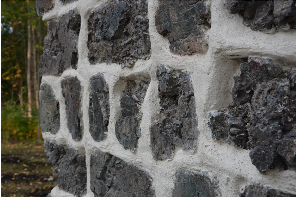
Närbild på pelare med rundade fogar, ett utseende som skiljde sig från föregående års släta fogar. De rundade fogarna beslutades att slipas ned. Vlm-knveb-0103.
